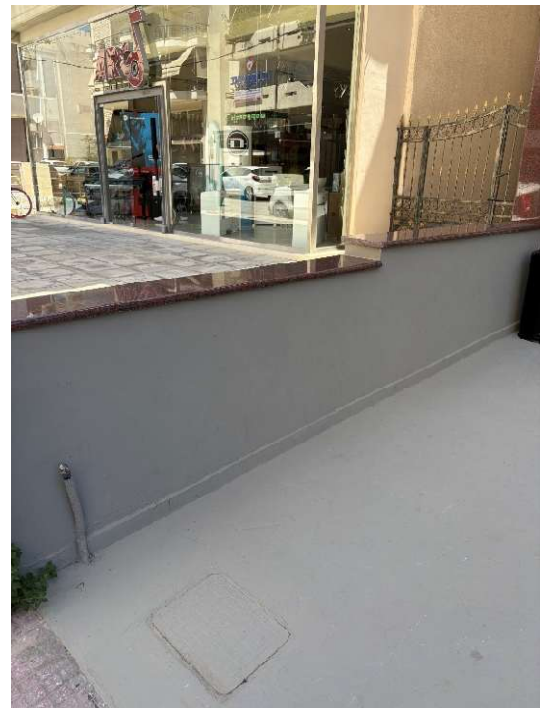
Εικόνα 4.12 «Εικόνα 4.10 «Κατασκευή τοιχίου επί της ζώνης όδευσης, η οποία προκαλεί στένωση του πεζοδρομίου»
