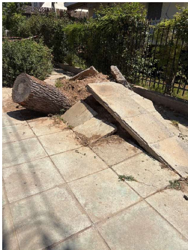
Εικόνα 4.50 «Ακατάλληλη χωροθέτηση φύτευσης με καταστραμμένες πλάκες από το ριζικό σύστημα του δέντρου που υποβαθμίζει τη βατότητα του πεζοδρομίου»
