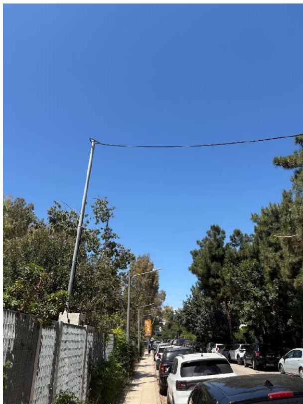
Εικόνα 4.65 «Καλωδιώσεις ΔΕΗ που περνάνε πάνω από το πεζοδρόμιο»
